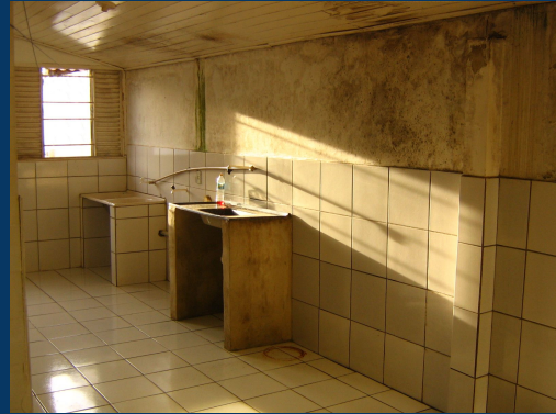
Ambiente insalubre e Iluminação / Ventilação naturais inadequadas
