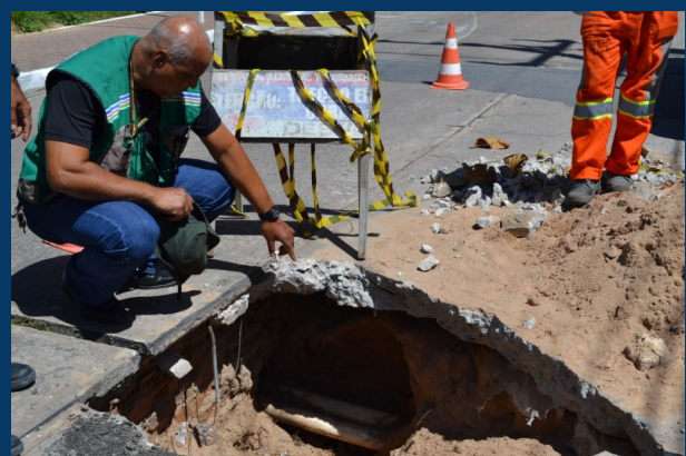
Ligações clandestinas de esgoto
